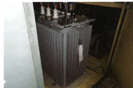
変圧器 (200KVA)・工事後
