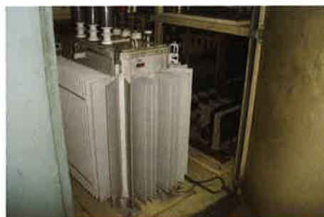
変圧器 (200KVA)・工事前
