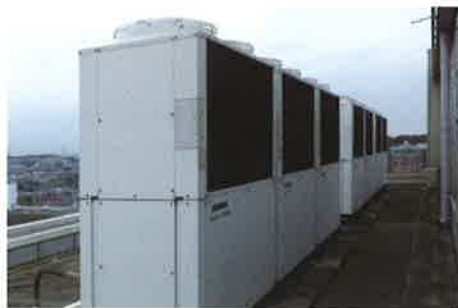
GHP 室外機・工事前
