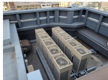
更新後(室外機)
