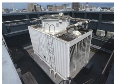
更新前(冷却塔)
