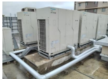
エアコン室外機
