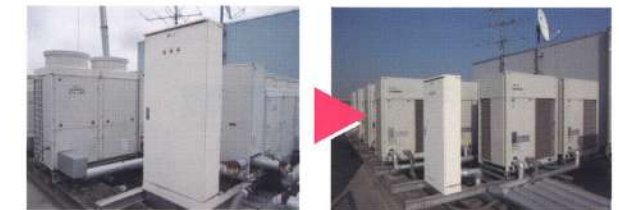
空調機室外機の更新前
